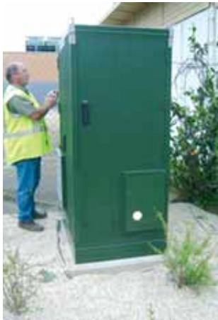
Armoire de rue
