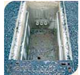
Chambre de raccordement
